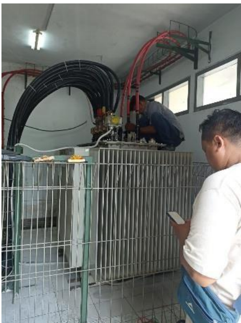
Gambar 3. Pengecekan trafo pada panel listrik
