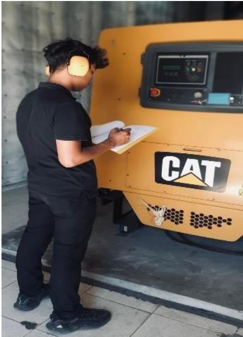
Gambar 1. Pengecekan jadwal pemanasan mesin genset
