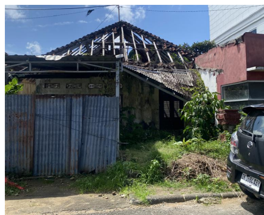
Dokumentasi 4. Foto Rumah Terbengkalai di Desa Dangin Puri Kauh
