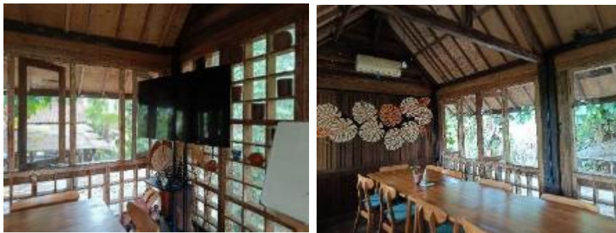
Gambar 11. Pendingin ruangan (AC sebagai pendingin ruangan rapat)
