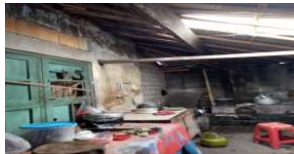
Foto 1. Kondisi Meja Dapur yang sudah dimakan rayap dan atap dapur yang rusak dan kotor (Dokumentasi Tim, 2017)
