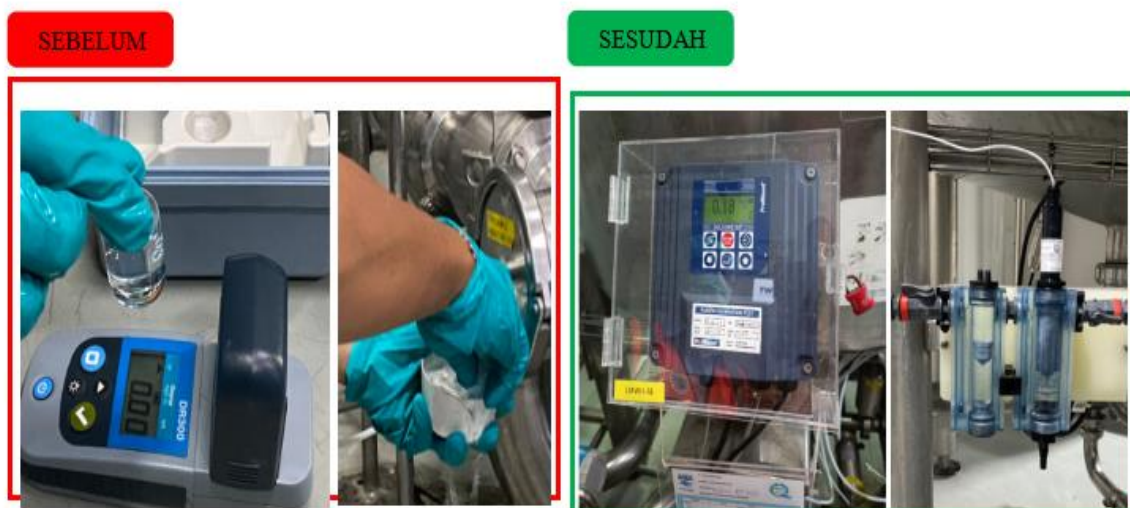
Gambar 1. Implementasi Sistem Interlock Online Monitoring Pada Ozonator Dalam Upaya Pengendalian Emisi
